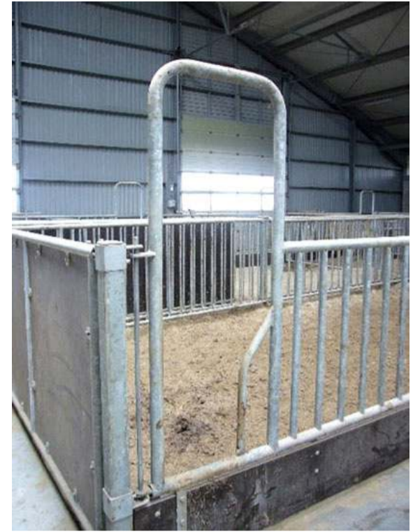
Allar burðarstíur ættu skilyrðislaust að vera með mannopum.
